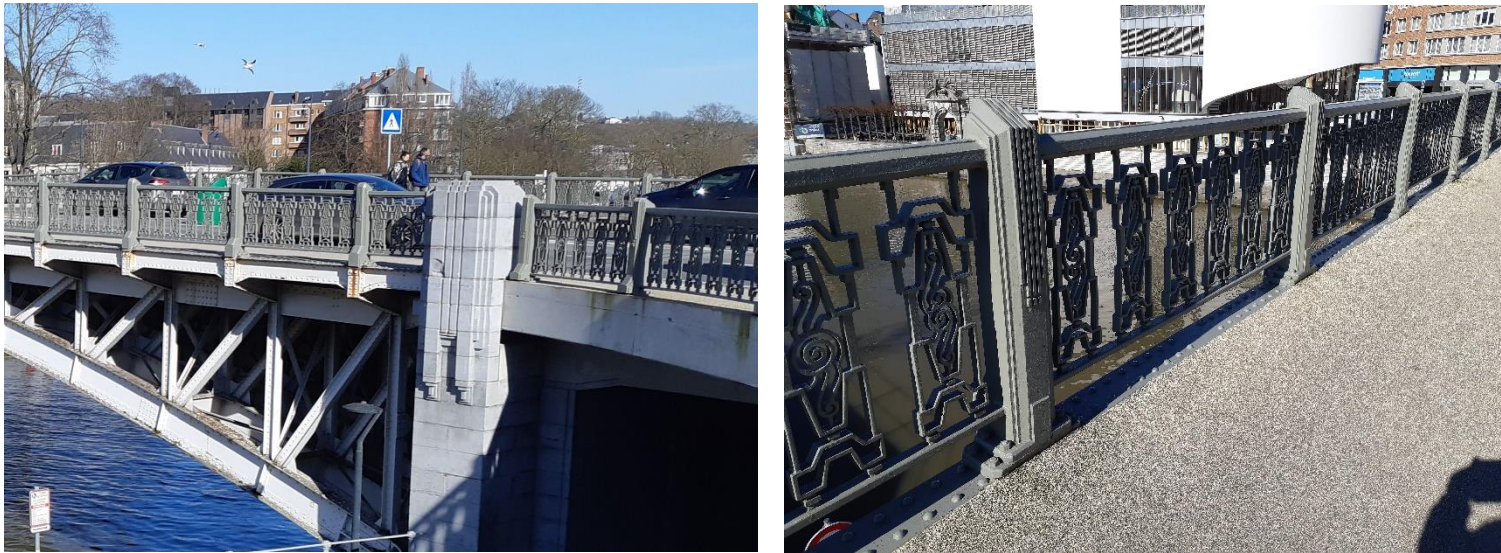
Fig. 16 et 17 : Détails architecturaux Art Déco du pont de France actuel (photographies M. Braham, février 2022)
