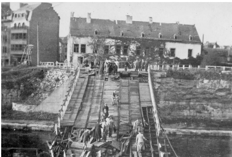
Fig. 14 : Le pont provisoire de 1940 détruit en 1944 (photographie non attribuée, coll. J. Marchal)
